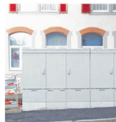
Hier laufen die Leitungen zusammen: „Multifunktionsgehäuse“ der Telekom. Foto: Tim Renner
